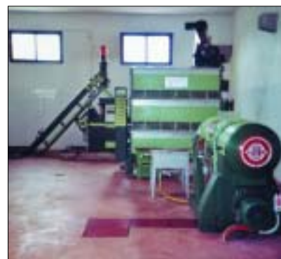
Gli impianti del frantoio
